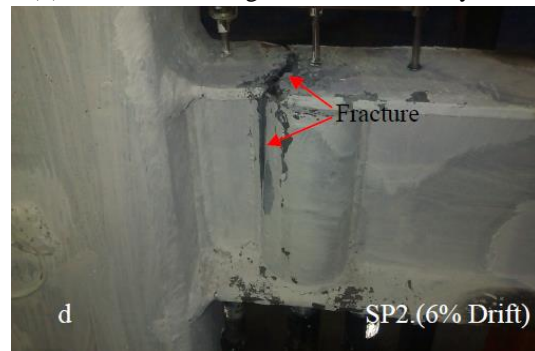
(d) Fracture in the right beam at 6% story drift
