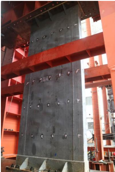
(d) Failure on side S
