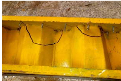
(b) Local web buckling
