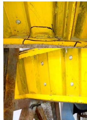
(b) Local web buckling
