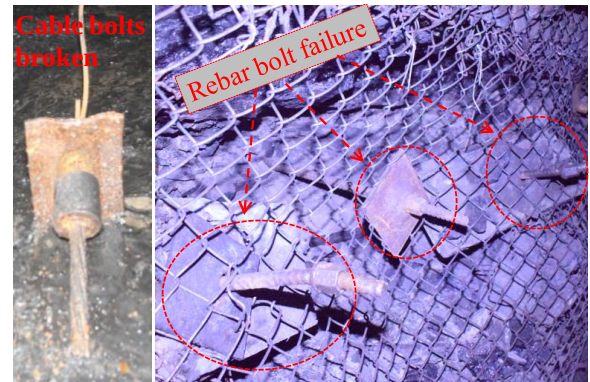
(d) Support failure
